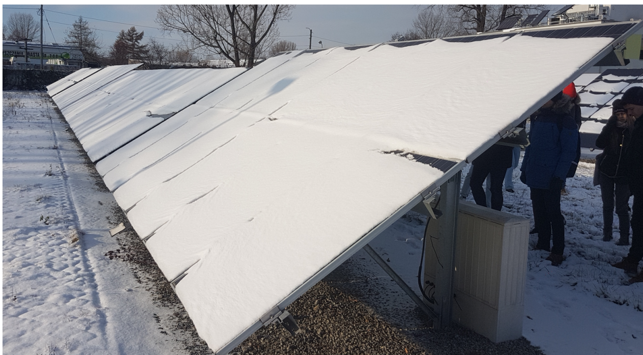
Zdj. 1 Instalacja fotowoltaiczna przed odśnieżeniem
