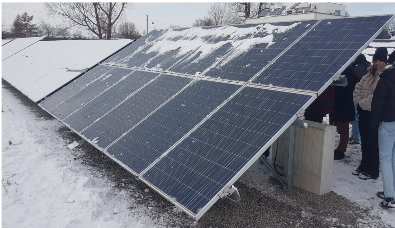
Zdj. 2 Instalacja fotowoltaiczna po odśnieżeniu
